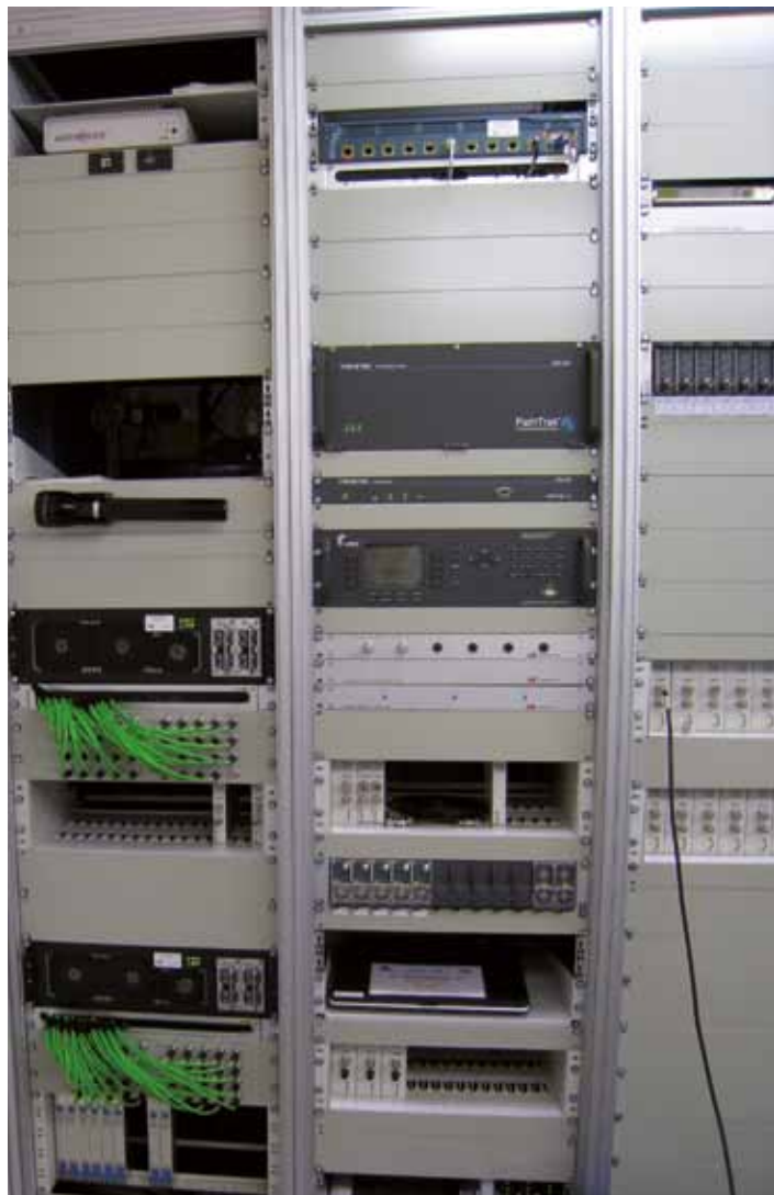
Rack mit CMTS-cable modem termination System
