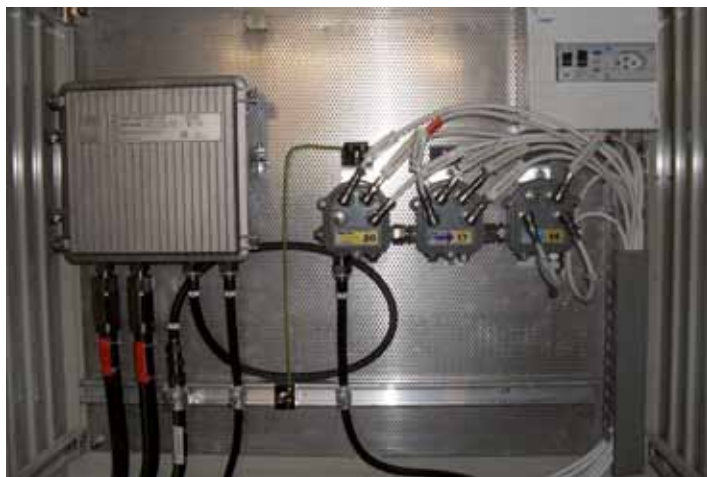
Sekundärverstärker in AP-Kasten mit Abgängen in die Hausverteilung
