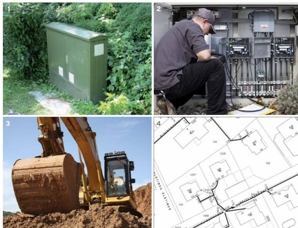
1 Armadio di distribuzione per la ricezione della televisione via cavo negli edifici circostanti / 2 Vista interna dell'armadio di distribuzione con le linee di collegamento per le abitazioni nelle vicinanze / 3 I lavori di scavo pianificati attentamente sono più efficienti / 4 Piano catastale con l'indicazione del passaggio dei cavi disponibile gratuitamente presso upc cablecom
